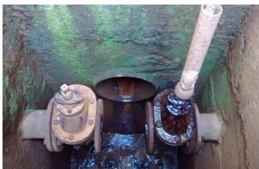
Figura 1: Vista do ponto de coleta do lodo na saída do decantador
